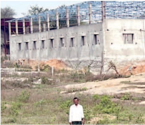
కూచనపల్లిలో ఆక్రమంగా నిర్మితమవుతున్న పరిశ్రమ కట్టడం
